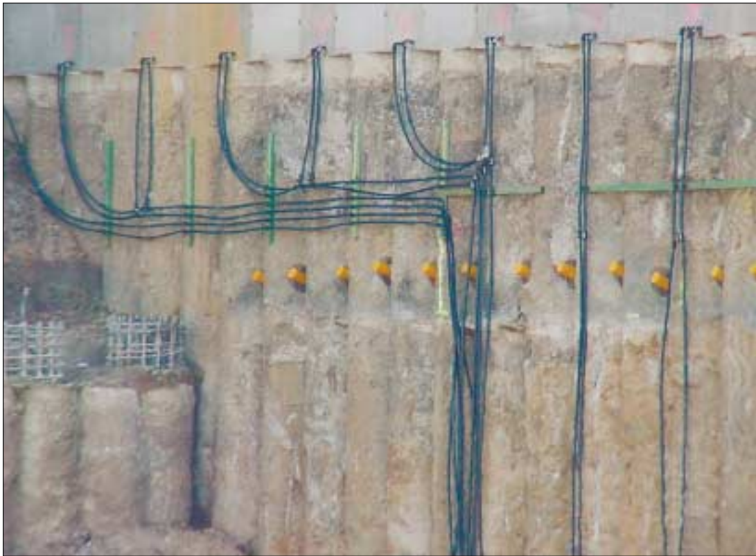
Abbildung 6: Sammelleitungen zu den Wärmetau- schern in der Bohr- pfehlwand bei der IHK Kiel (Foto: Dr.- Ing. Bernd Kriegel Ingenieure GmbH, Kiel)
