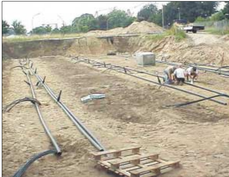
Abbildung 3: Erdwärmesonden- feld am Zentrum für Energie und Technik ZET in Rendsburg (Foto: E.ON Hanse, Quickborn)
