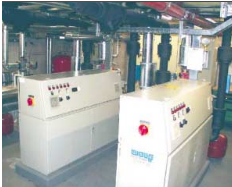
Abbildung 4: Wärmepumpenan- lage zur Versorgung des Zentrums für Energie und Tech- nik (Foto: E.ON Hanse, Quickborn)
